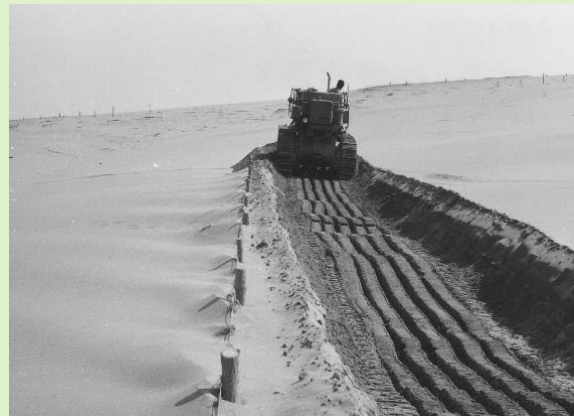
堆積した砂を除去 昭和48年(1973)頃
